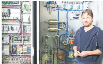
Hightech vom Feinsten: Servicetechniker Norman Karlsen vor dem Schaltschrank mit der Elektronik- und der Hydraulik-Steuerung.
